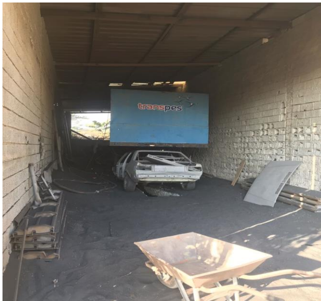
Exemplo de parede em alvenaria (blocos de concreto) desgastado pela ação do jateamento
